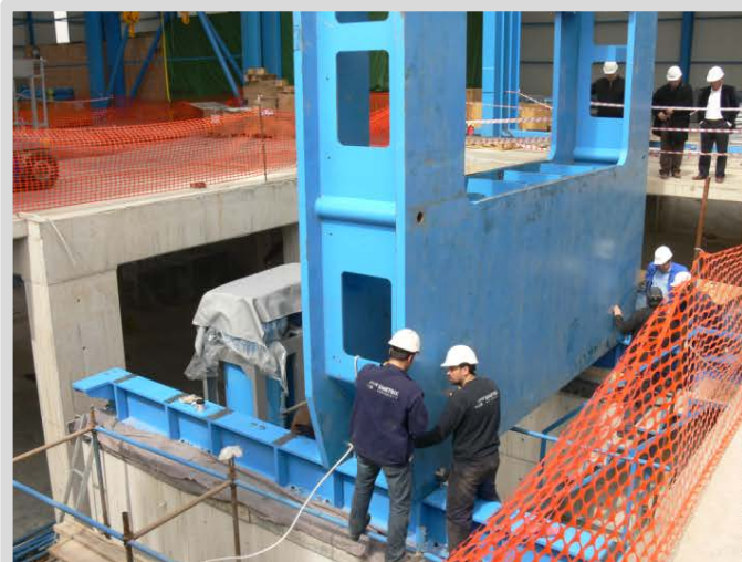
1.hol Betonarme Ayaklara Pres Ünitesinin Montajı - Mounting Of Hall 1 Press Unit On Rc Base
